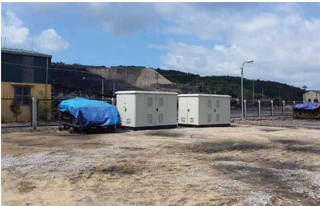
Cung cấp lắp đặt 02 TRẠM BIẾN ÁP 400kVA cho Công ty THAN HÒN GAI TKV Provide and install two 400kVA SUBSTATIONS for HONGAI COAL COMPANY
